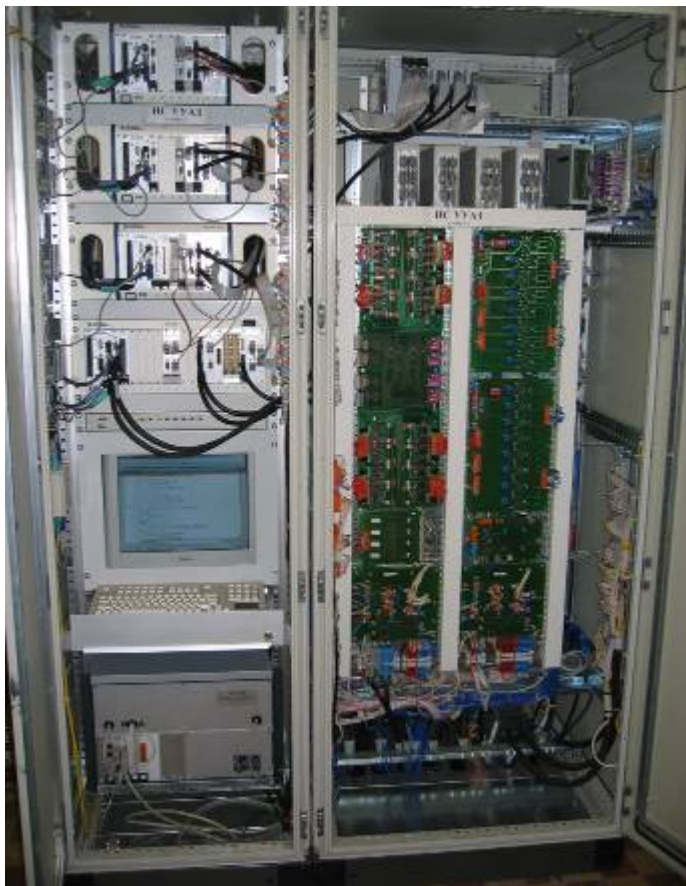
Рис.6. Система управления и аварийной защиты, созданная НИИХИММАШ для испытаний 3-ей ступени РН «Русь»
